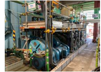
添加材注入ポンプ
