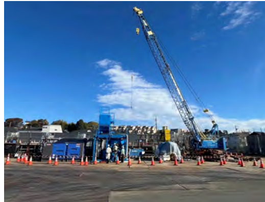
Hランプ工事 大正橋付近から北西方向を望む (令和6年11月27日)
