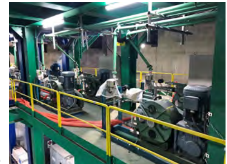
起泡溶液 注入ポンプ
