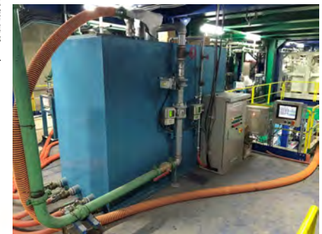
起泡溶液 作液タンク
