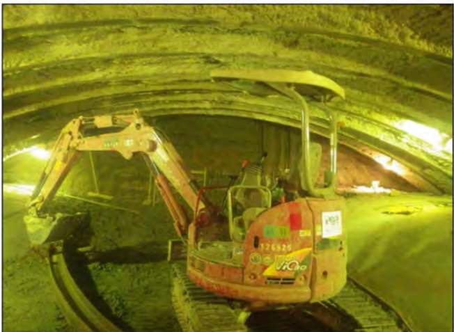
鋼アーチ支保工設置 油圧ショベル【低騒音型・低振動型】
