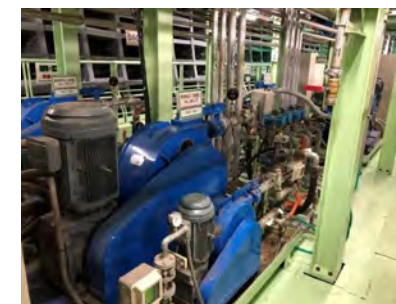
添加材注入ポンプ
