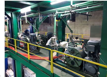
起泡溶液 注入ポンプ
