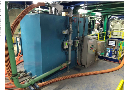
起泡溶液 作液タンク
