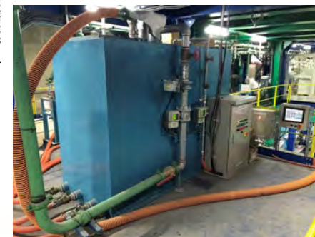
起泡溶液 作液タンク
