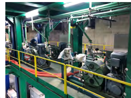
起泡溶液 注入ポンプ
